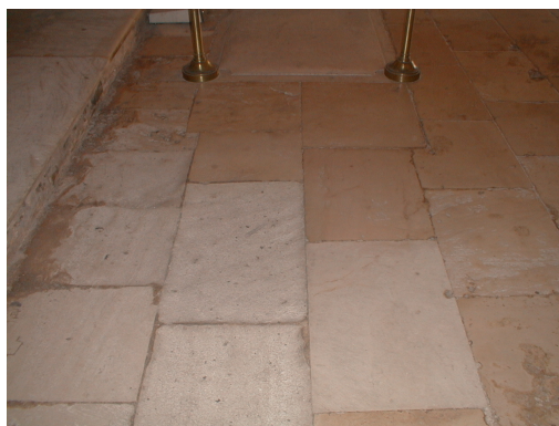
As lajes mais clara serão as originais, com evidentes sinais de desgaste, notando-se o remendo do pavimento aquando da deslocação do túmulo
